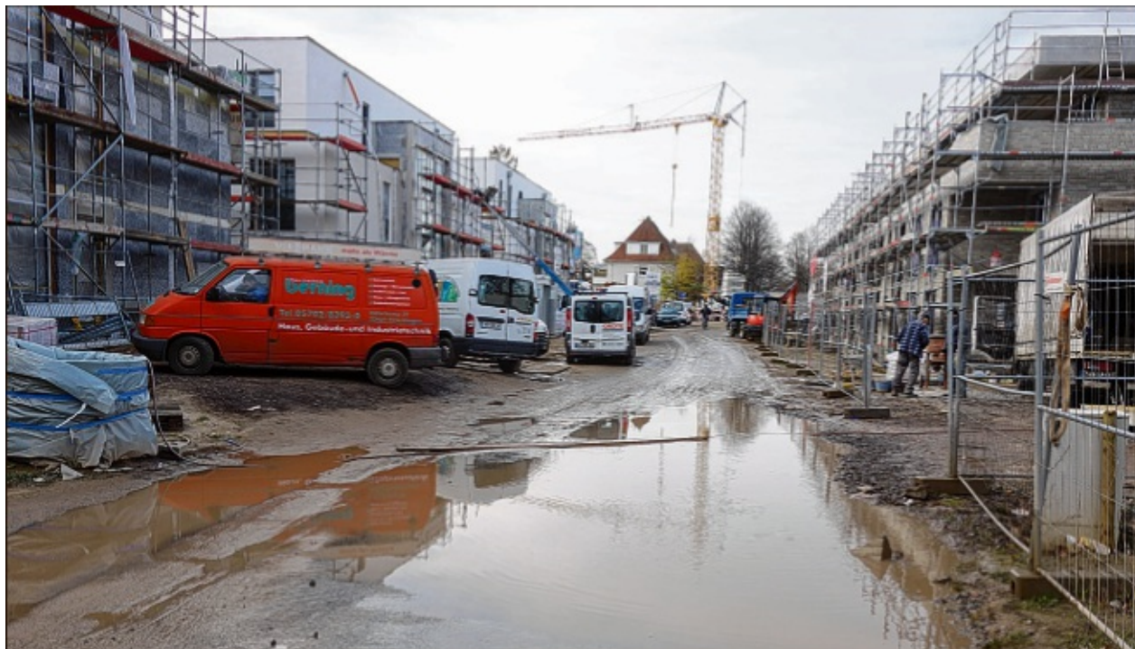
Vor allem Fußgänger haben es schwer, wenn sie die Strecke passieren. Allerdings handelt es sich laut Stadtverwaltung um eine Baustraße, die für den öffentlichen Verkehr nicht vorgesehen ist. MT-Foto: Stefan Koch
